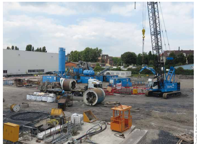
Bild 8 Baustelleneinrichtung hydraulisch gestützter Rohrvortrieb (TBM im Vordergrund) Site equipment hydraulically supported pipe jacking (TBM in foreground)
